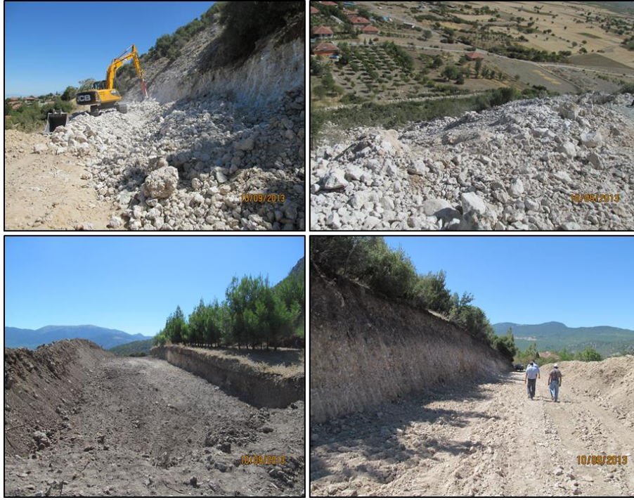
Şekil 2.39 Bozkurt İlçesi İnceler Mahallesiinde kaya düşmesi afeti etüt çalışmalarına ait arazi gözlemlerine ve ıslah çalışmalarına ait fotoğraflar
